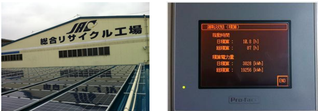
【図表 26】 太陽光発電設備
